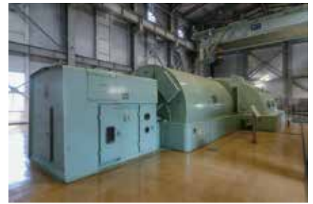
タービン・発電機
