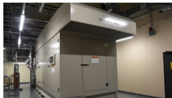
天然ガスコージェネレーションシステム
