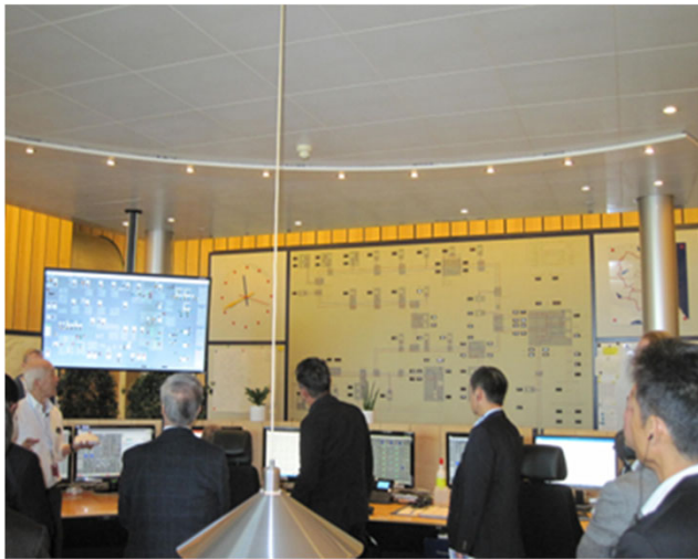
(写真：CTR中央監視室)
