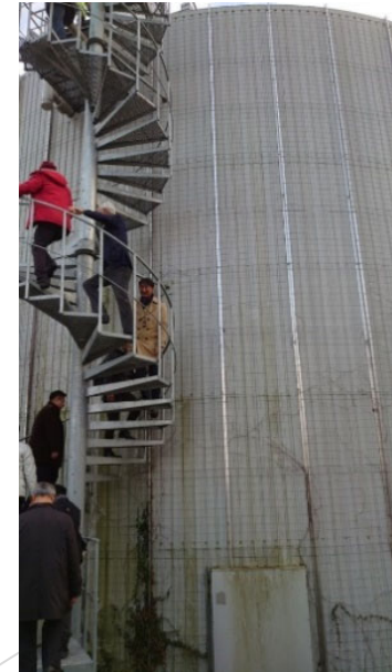
(写真：冷水蓄熱タンク)
