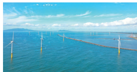
秋田港に広がる洋上風力発電 (写真提供:秋田洋上風力発電(株))
