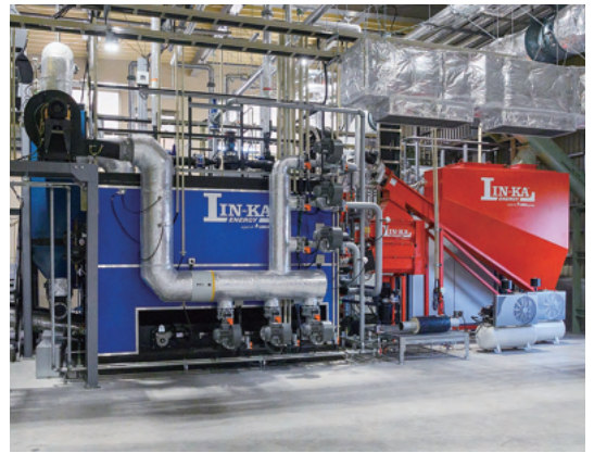
もみ殻バイオマスボイラー (デンマーク製・350kW×2)
