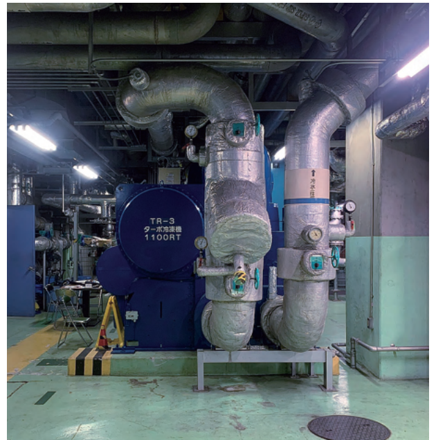
図5 「広島市紙屋町熱供給センター」の電動ターボ冷凍機
